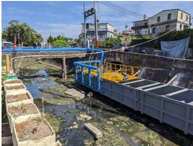
圖 16 中港溪尖山下圳抽水至東興淨水場
