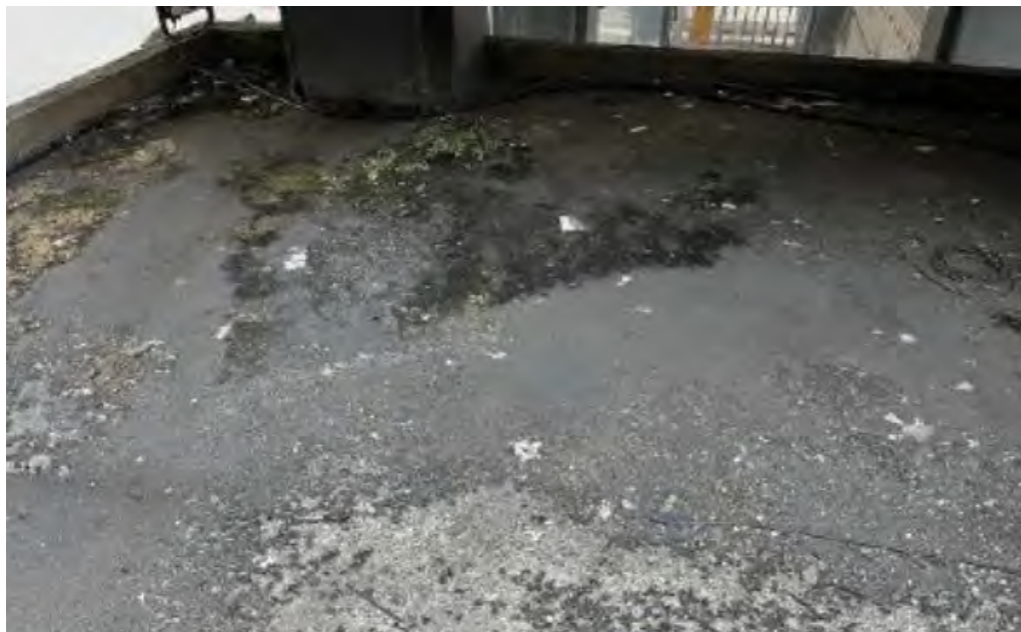
現況屋頂長期積水
