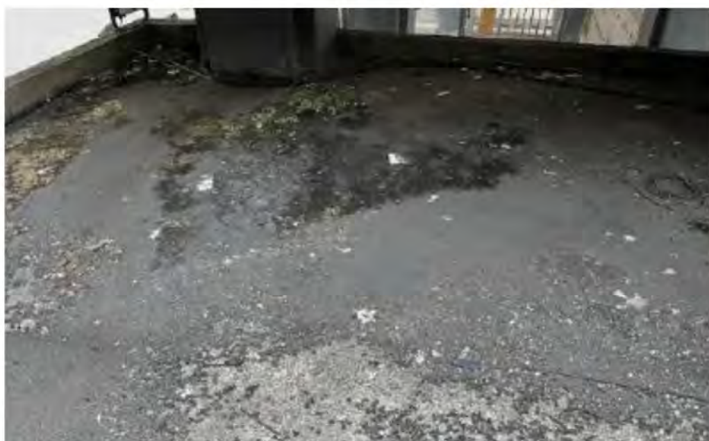
現況屋頂長期積水
